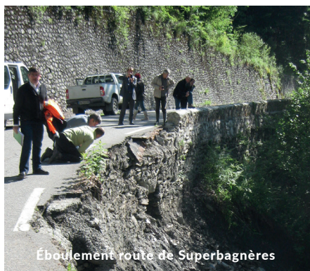
Éboulement route de Superbagnères
