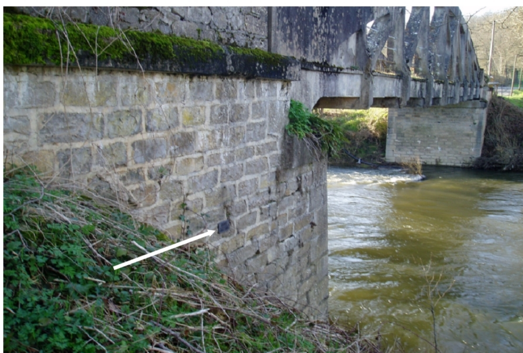
Repère de la crue du 03-04/12/2003
