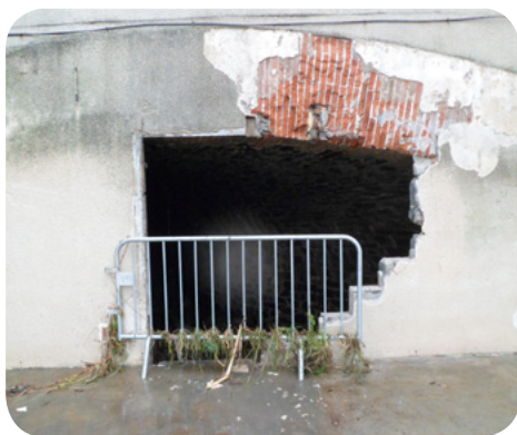
Rupture du mur fusible © Mairie de Port-Vendres.
