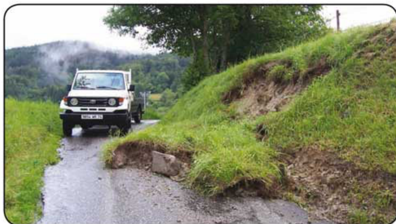
▲ Glissement de terrain dans un talus en bordure de chemin communal suite aux fortes pluies de juillet 2007
