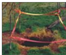
Mouvement de terrain (cavités souterraines)
