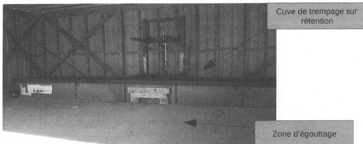
Photo 2: Installation de traitement du bois
