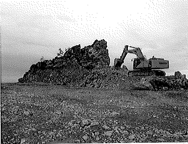
Pelle immobilisée sur la zone des travaux au pied du front restant à détruire sur le versant ouest Altitude du carreau 705 NGF
