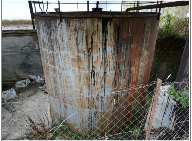
Réservoir de fioul lourd
