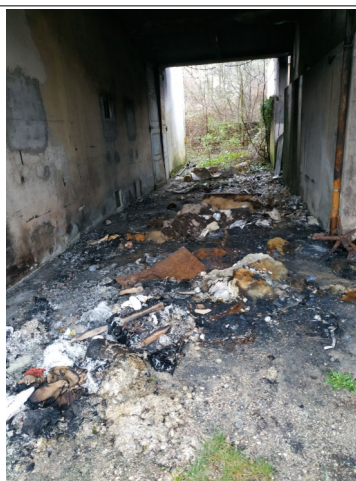
Traces d'un incendie avec résidus imbrulés sous le porche
