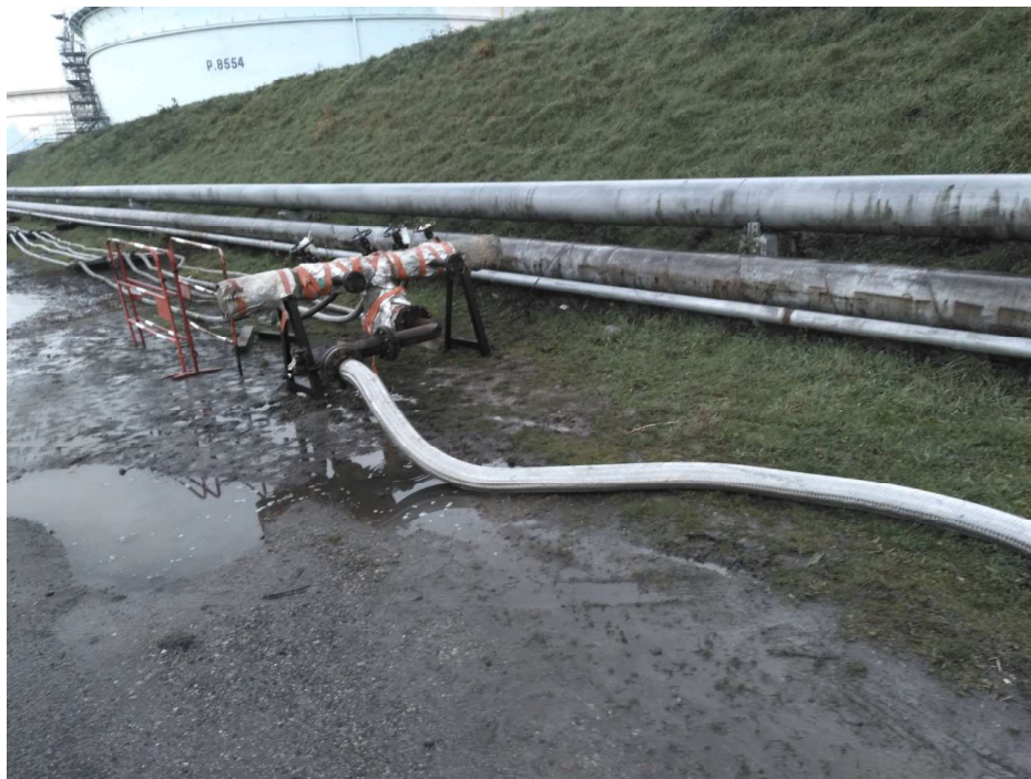
Tuyaux mis en œuvre pour la connexion de la maintrap au bac P552
