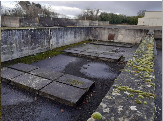
Rétention bitume devant faire l'objet d'un nettoyage
