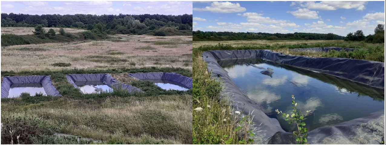
Bassins de décantation, et soulèvement au niveau du deuxième bassin.
