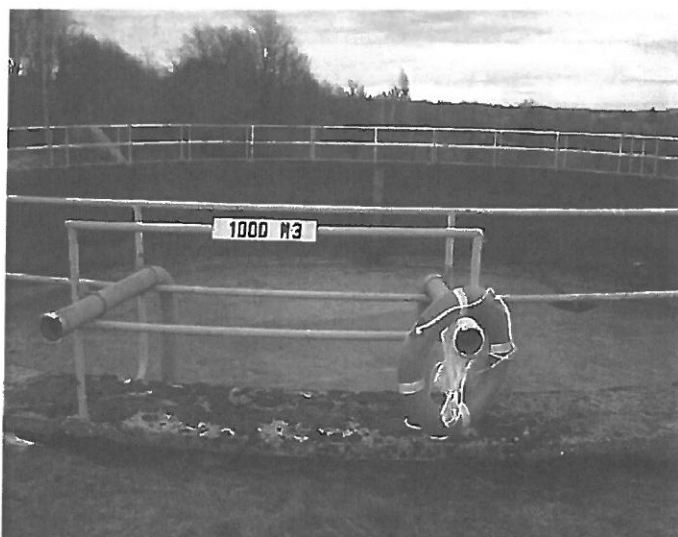
Réserve incendie vide
