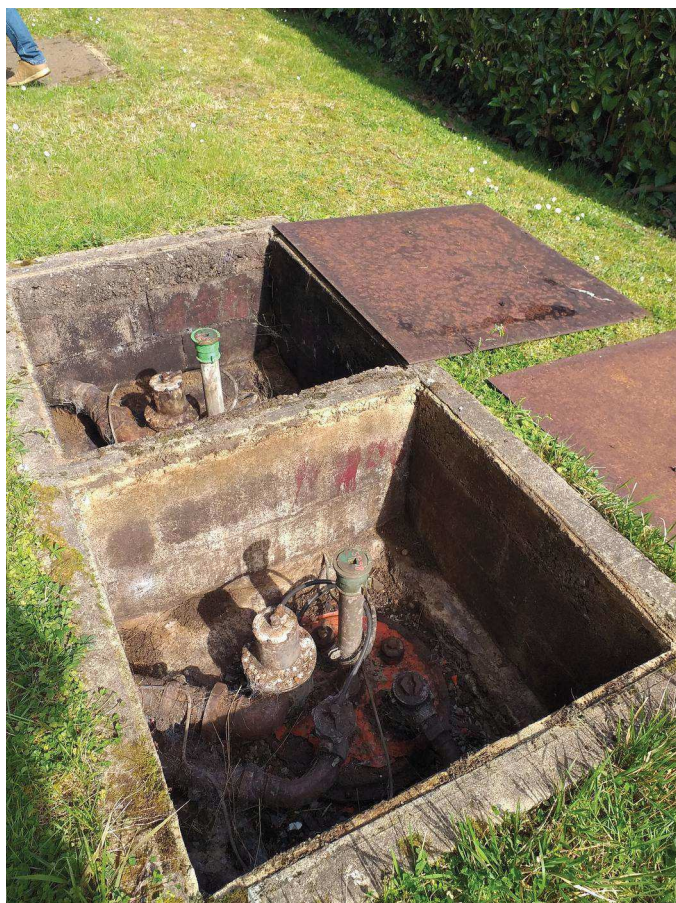
Vue avec plaques soulevées sur le dessus des cuves enterrées
