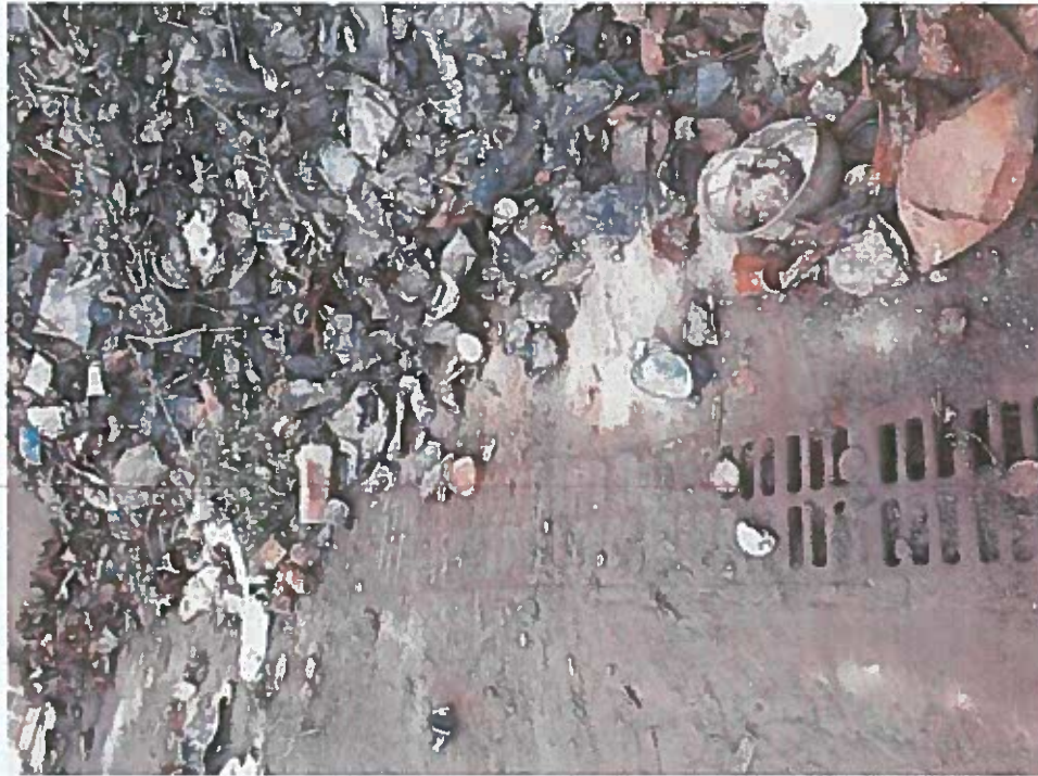
Grille de collecte des eaux polluées, colmatée, au niveau de la zone d'entreposage des mâchefers et des déchets métalliques extraits des mâchefers
