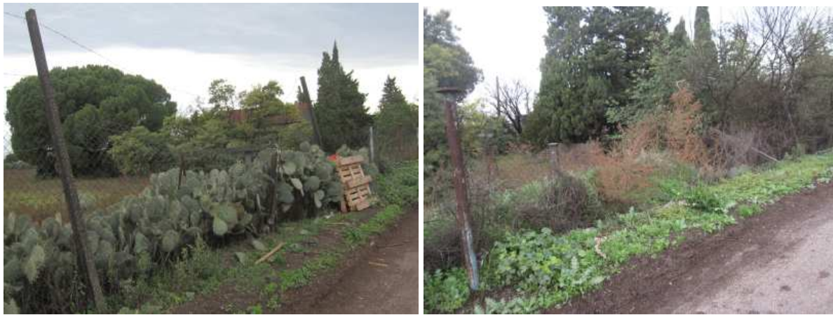
Fig.4 : Clôture endommagée coté ouest
