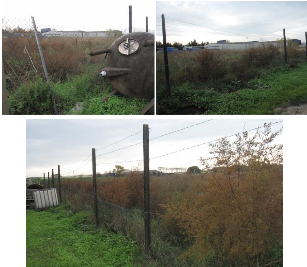
Fig.3 : Clôture endommagée coté sud
