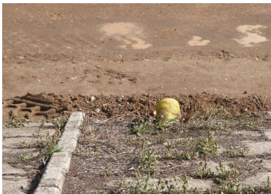
Canalisation abandonnée repérée en jaune
