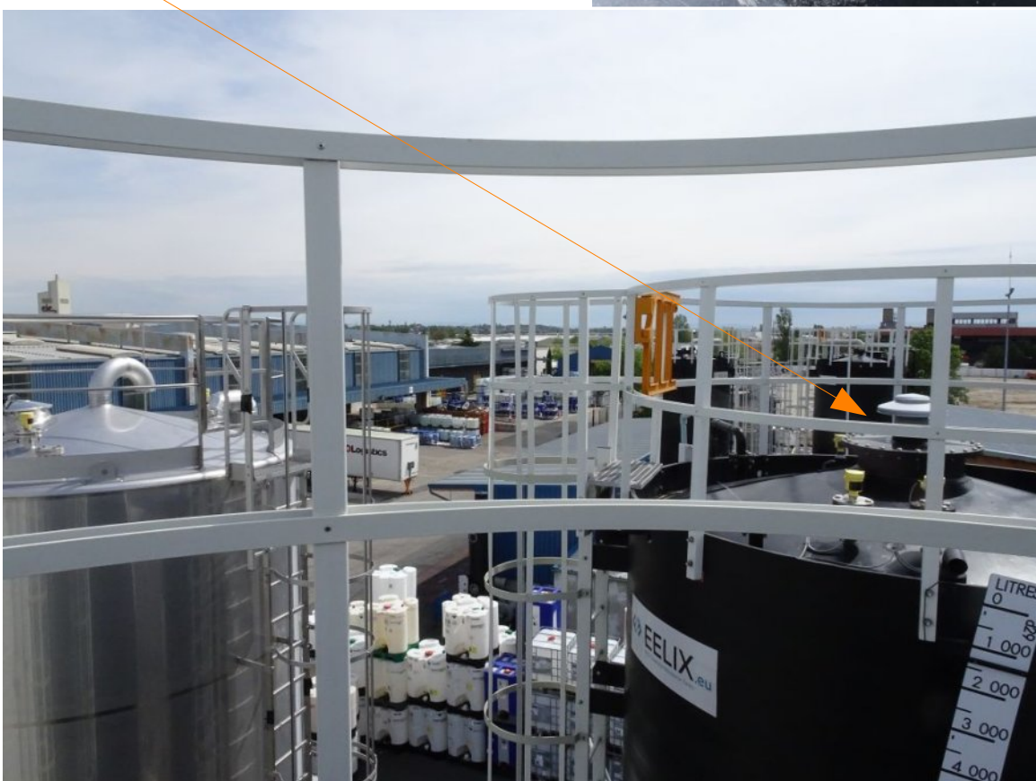
Vue 7 - Événement, réservoir R23000
