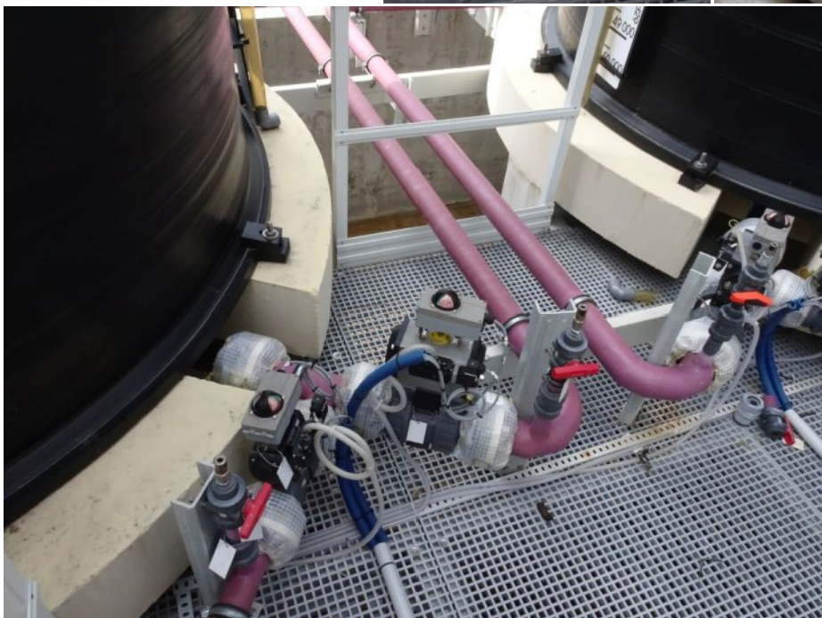
Vue 4 - Ligne d'alimentation de Javel, actionneur et vanne reliés au pressostat
