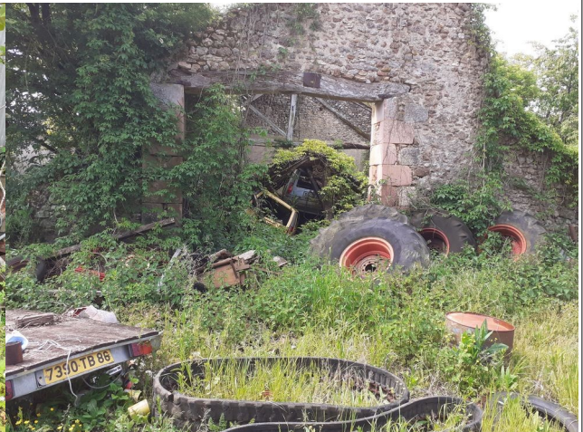
Repère n° 4 : des véhicules sont stockés dans un bâtiment dont le toit s'est effondré.
