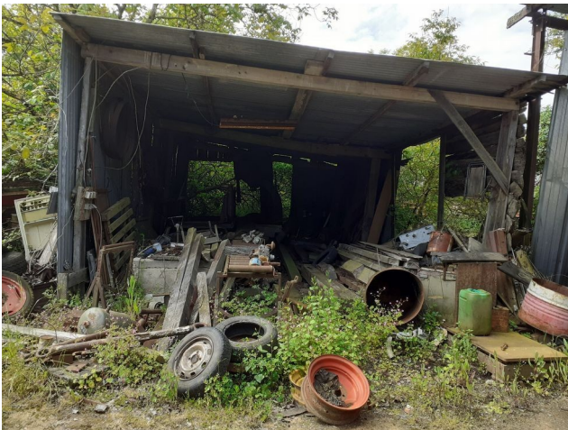
Repère n° 3 : hangar abritant des déchets
