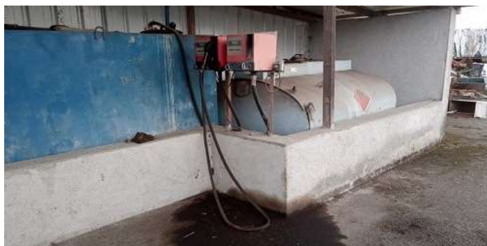
Cuve de gazole et poste de distribution
