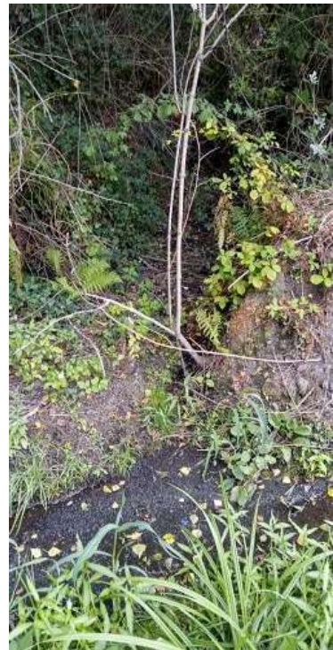
Embranchement avec eaux provenant de la RN 134
