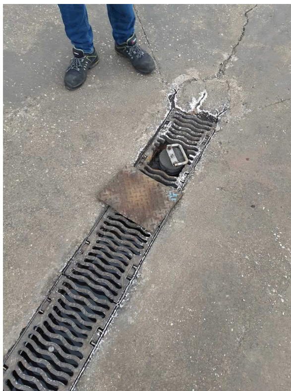
Aire de dépotage d'une cuve de soude, avec bouchon d'isolement et fissures
