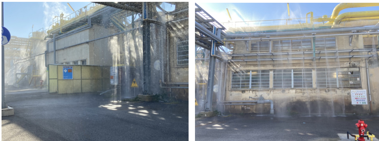
Rideau d'eau autour du bâtiment compression chlore.
