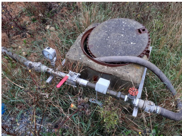
Pompe de vidange de la lagune à l'arrêt, vannes fermées
