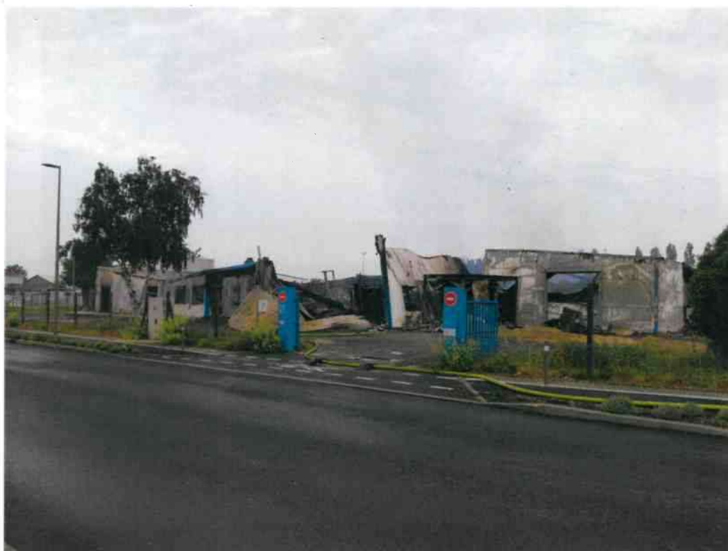
Annexe : photos prises sur le site de la société SECO, le 13 juin 2023
