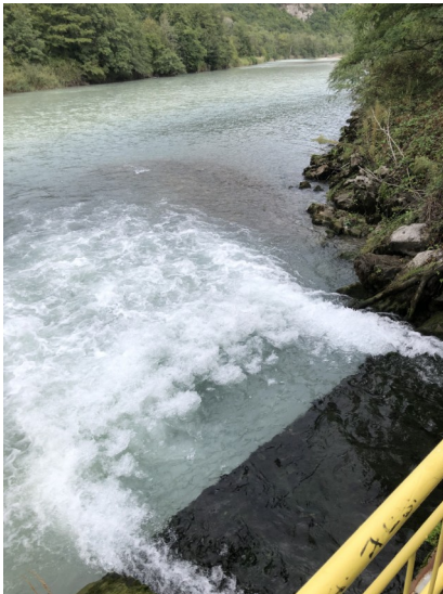
Sortie rejet général dans le Drac
