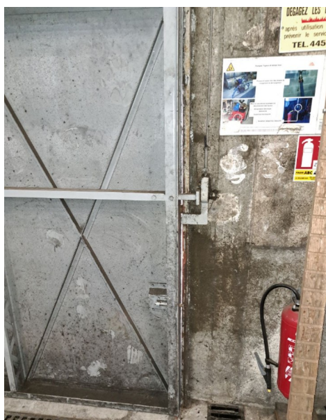
Jour visible entre la porte et le dormant
