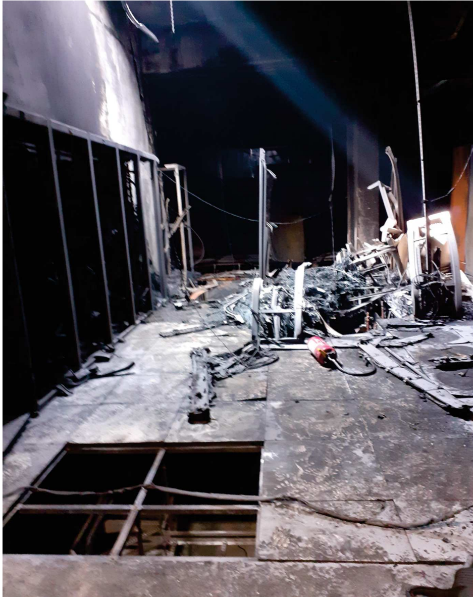
Annexe : photo du local après l'incendie
