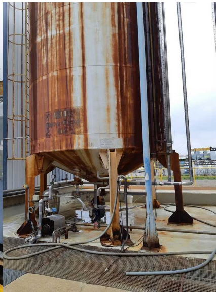
Une des 2 cuves de soude
