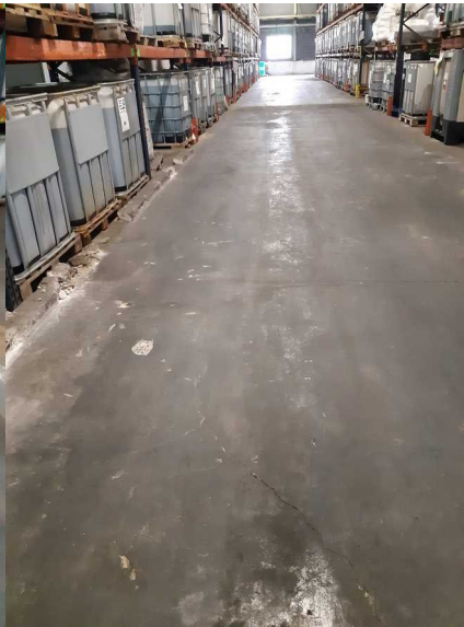
Mauvais état du sol dans le magasin
