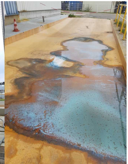
Sol de l'aire de dépotage AD2 avec des écoulements et présentant des fissures
