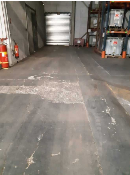
Présence d'une porte fermée côté « piscine » et mauvais état du sol dans le magasin
