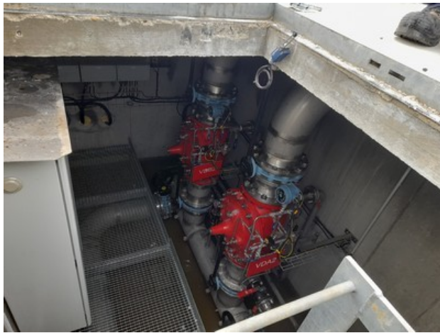
Chambre de vannes semi-enterrée qui alimentent le réseau des déversoirs par sous cuvette A2 et B2
