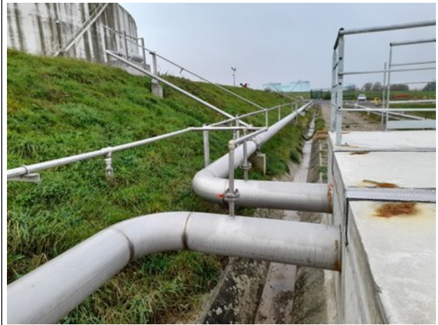
Réseau d'alimentation des déversoirs sectionné par sous cuvette A2 et B2
