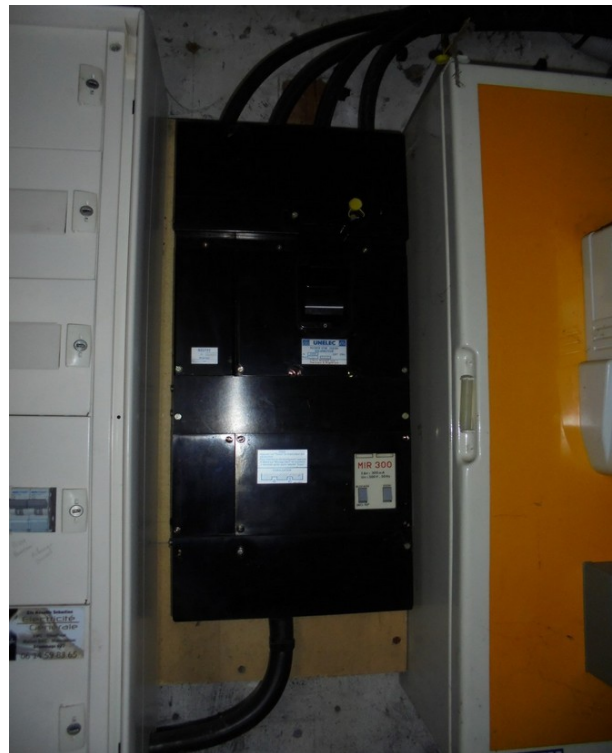
Coupure générale électrique : à signaler à l'extérieur par panneau
