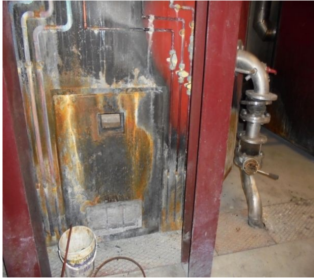
Chaudière endommagée (arrière)
