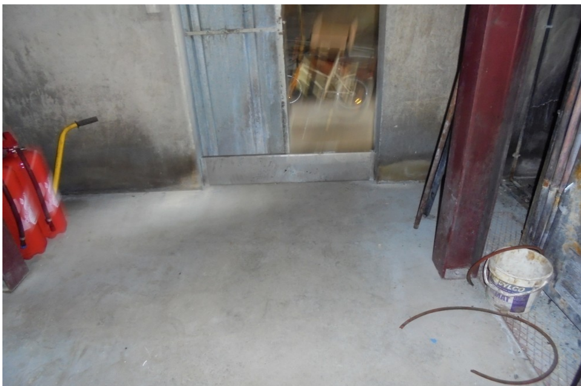
Seuil de la seconde issue avec joint endommagé (fondu)
