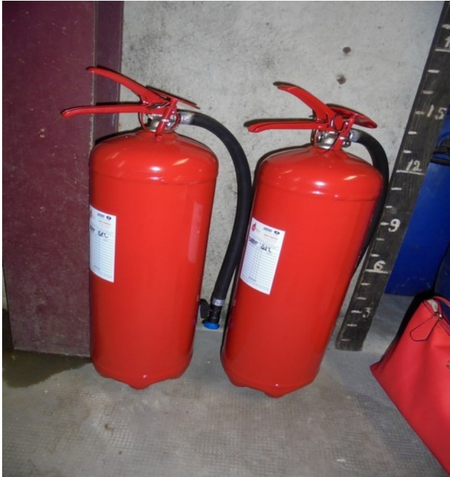
Nouveaux extincteurs neufs à positionner dans la distillerie
