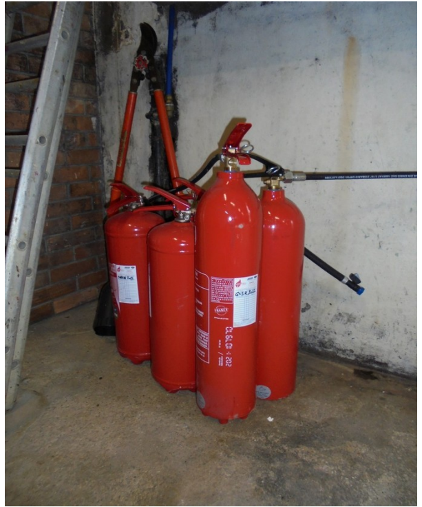
Ensemble d'extincteurs neufs à distribuer dans l'installation
