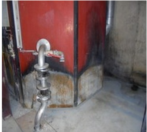
Chaudière endommagée (avant)
