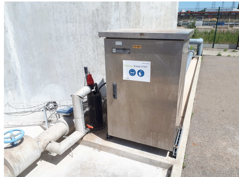
Le préleveur en entrée de station
