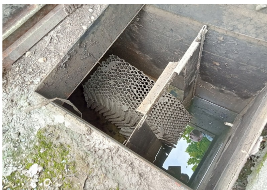
Illustration 1: État du séparateur d'hydrocarbures
