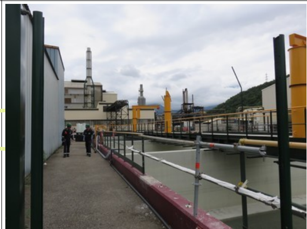
Bassins tampon+passerelle+rack Sud
