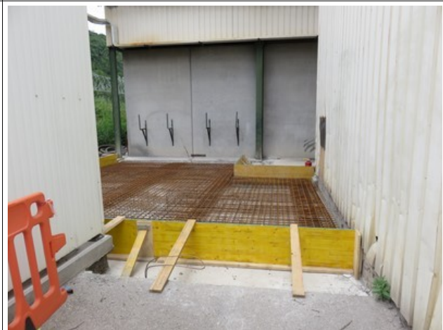
Futurs filtres à sable STEP Chimie
