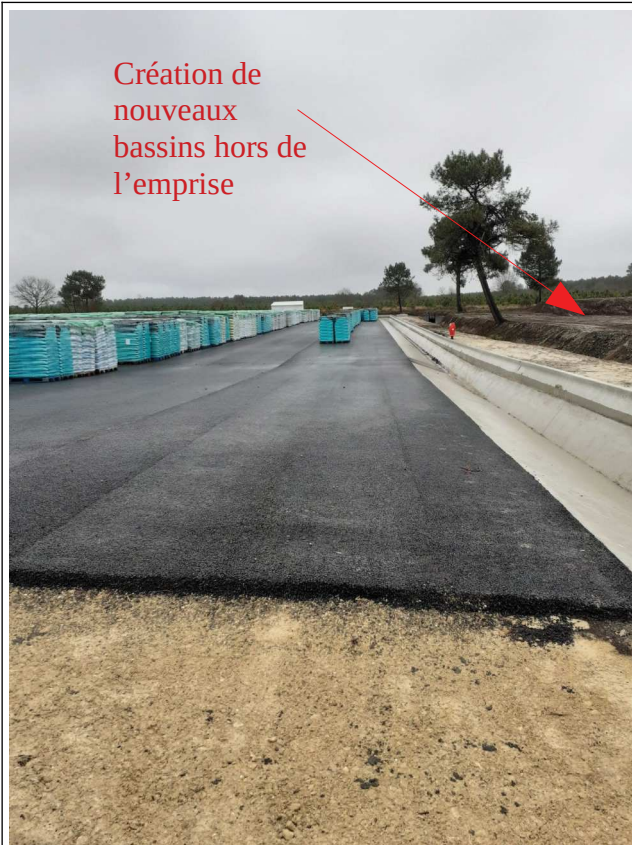
Photo 1 : Zone imperméabilisée avec caniveau pour rétention des eaux d'extinction
