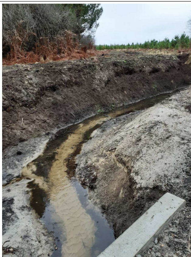
Photo 14 : réseau de fossés (biolandes technologie + biolandes pin décor)
