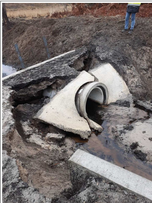
Photo 13 : Buse de régulation du débit non stabilisée
