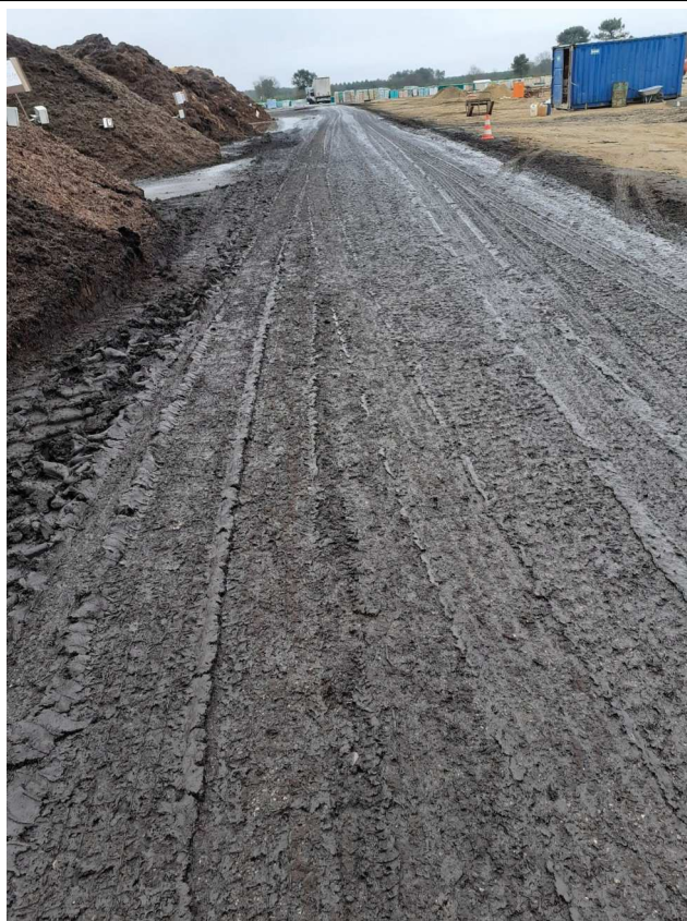
Photo 5 : sol chargé de matières. Etat de propreté du site non assuré.
