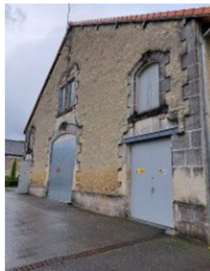
Présence de portes en bois : caractère E30 à établir
