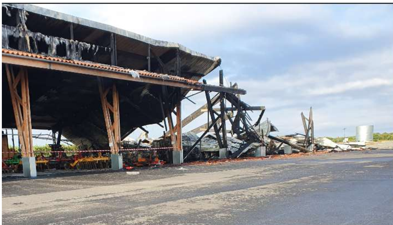
Hangar incendié, la partie effondrée à droite abritait notamment l'engrais organique
