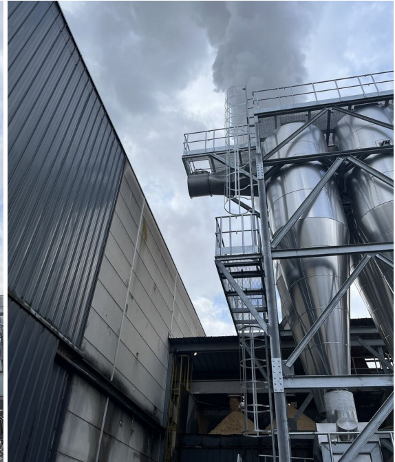
Absence de raccordements (prévu pour l'arrêt technique sem.52 2023)
