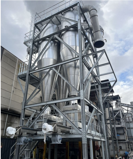
Cyclone HURRICANE 4 RE 1800 (installation de dépoussiérage)
